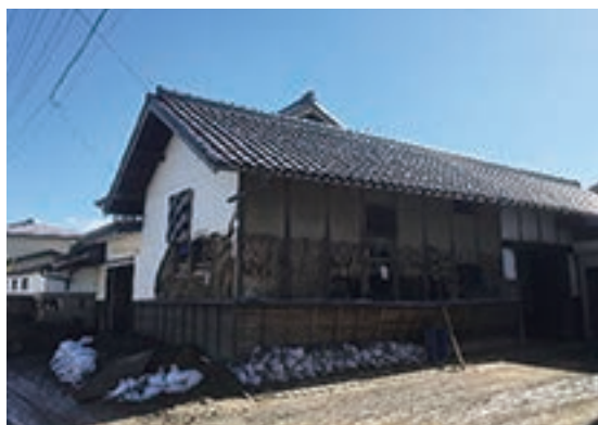
修繕前の小川醸造場さんの土蔵の被害状況です。土壁が崩れ落ちてしまいました。
