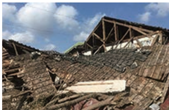
小川醸造場さんのみそ製造建屋の被害状況です。屋根ごと崩れ落ちてしまいました。
