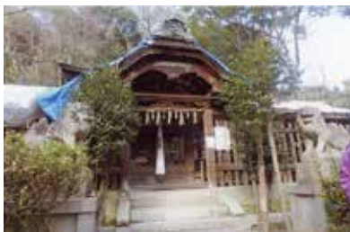
本殿屋根にブルーシートが掛かっている「蟬丸神社下社」
